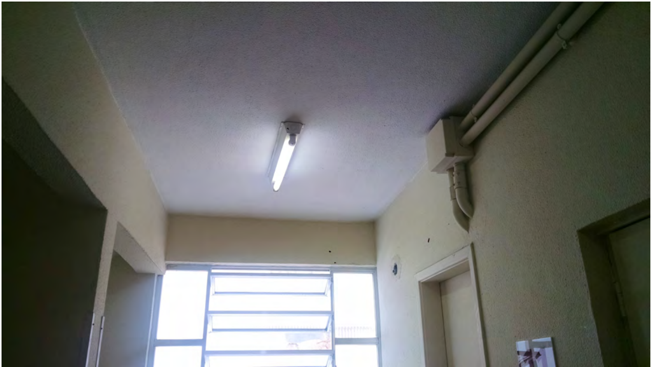
Ausência de câmera de circuito interno
