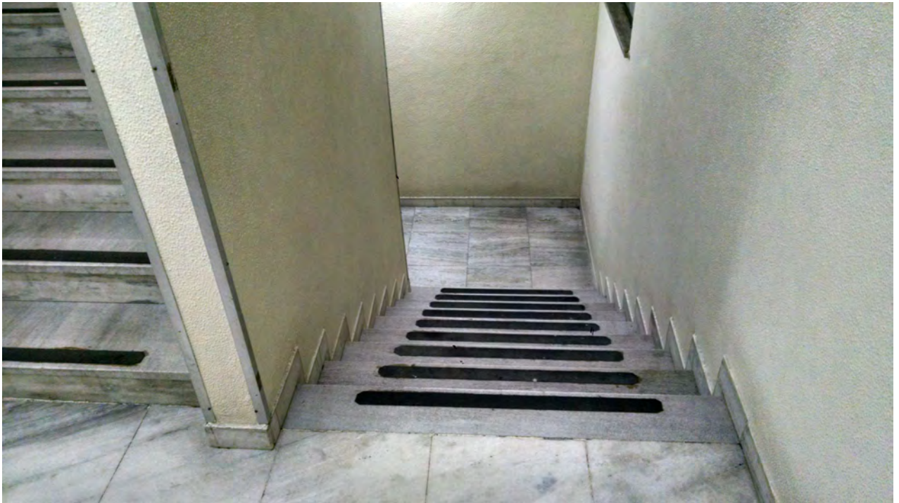
Escada sem corrimão
