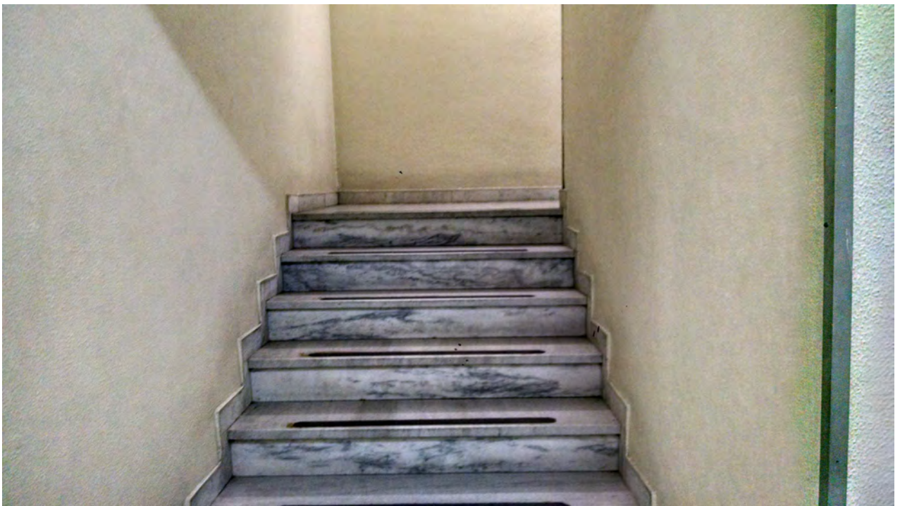
Escada sem corrimão
