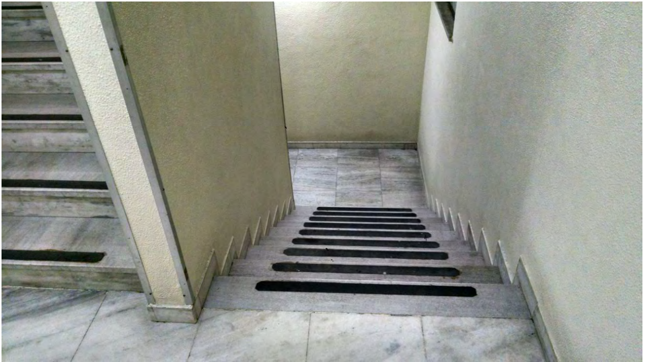
Escada sem corrimão
