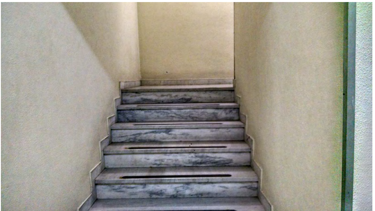
Escada sem corrimão
