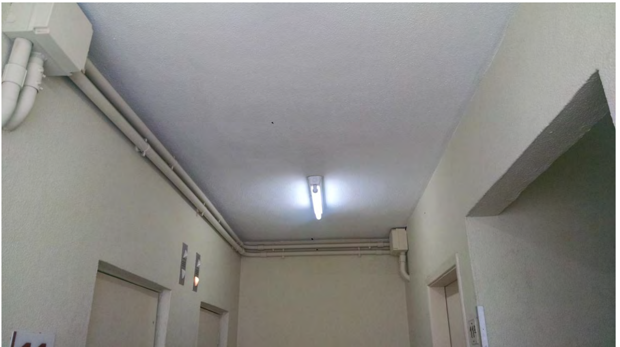
Ausência de câmera de circuito interno
