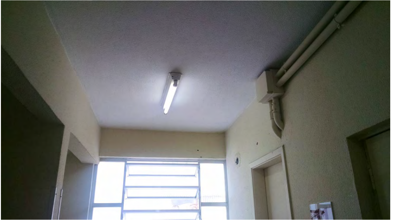
Ausência de câmera de circuito interno
