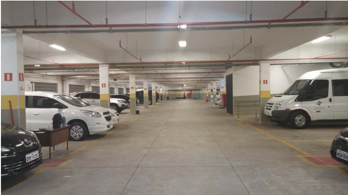
Garagem sem extintor de incêndios
