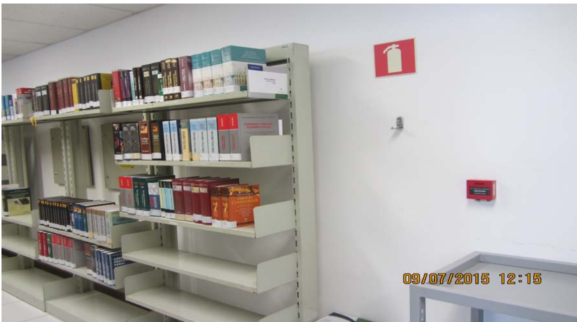
Biblioteca sem extintor de incêndio
