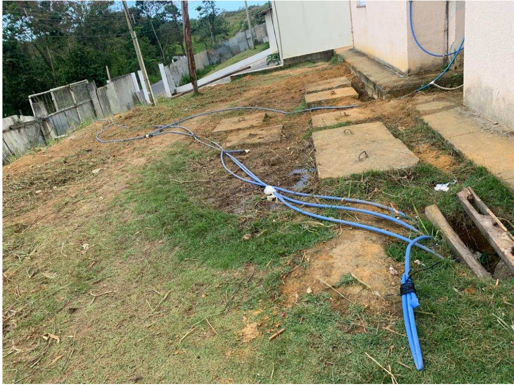
Rede hidráulica improvisada pelos ocupantes.
