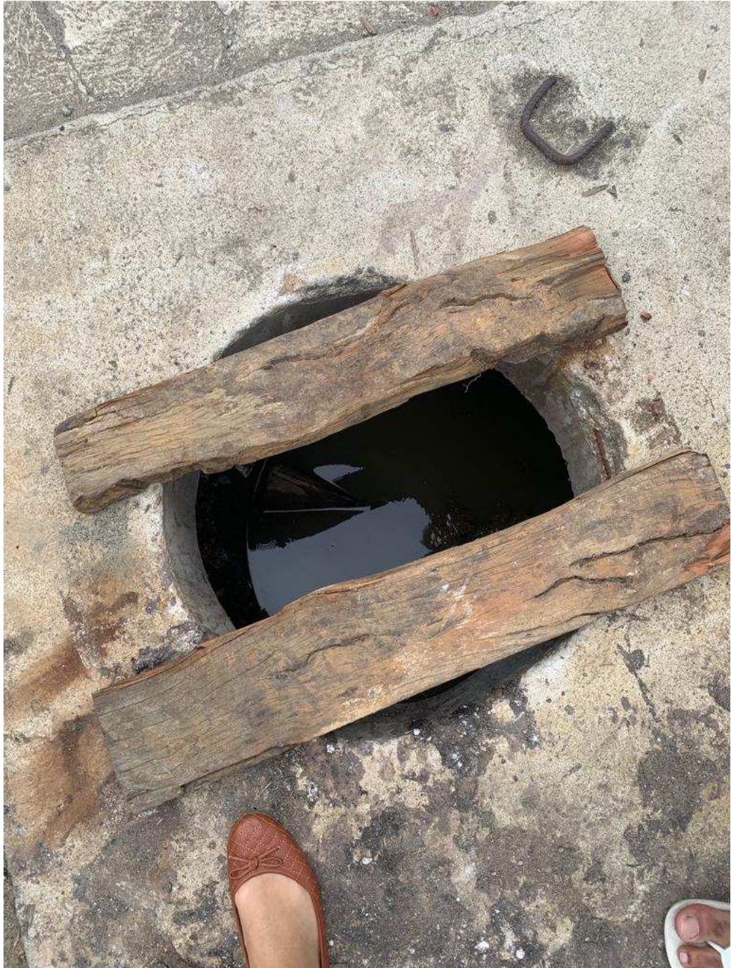
Rede de drenagem de água utilizada para o esgotamento sanitário do empreendimento.
