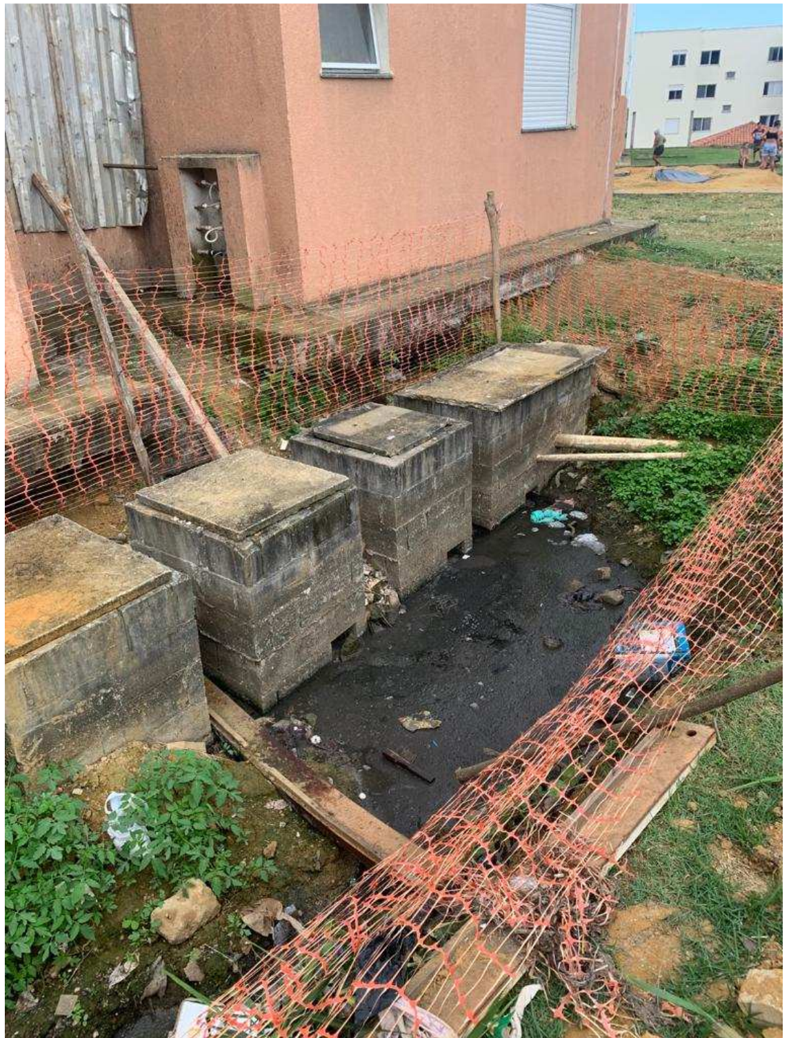
Esgoto a céu aberto em um dos blocos do empreendimento.
